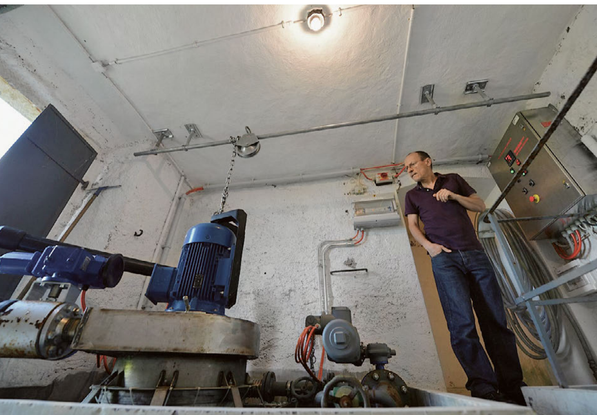
La micro-turbine de couleur bleu a une puissance de 6,5 kW. L'armoire électrique est à droite. Louis Godet est la personne par laquelle le projet a été réalisé.
